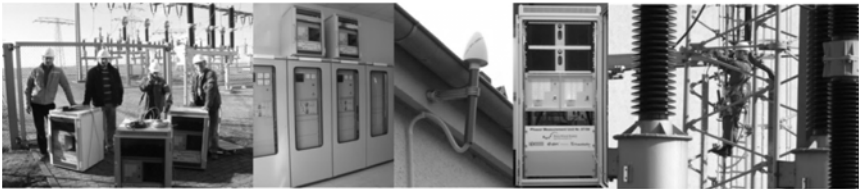
Abbildung 12: Aufbau und Installation der PMU-Messausrüstung
